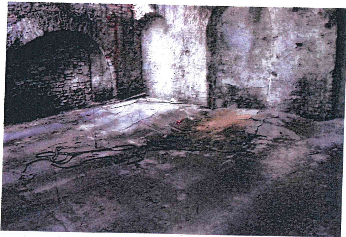
Fot. 17. Wnętrze części halowej; wybrzuszenia i spękania betonowej posadzki przy ścianie północnej
