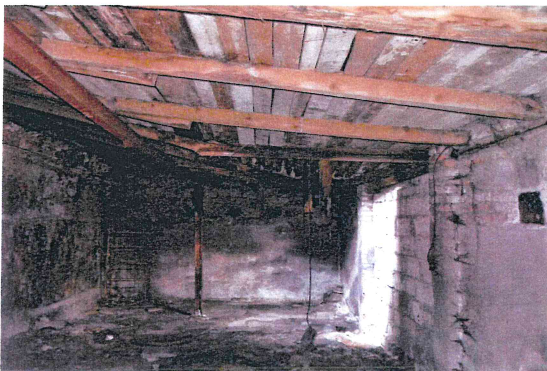
Fot. 10. Elewacja północna i widok wnętrza przybudówki; dach dobudówki w stanie awaryjnym
