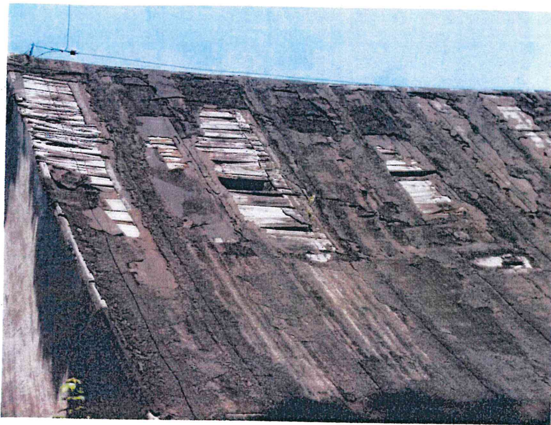
Fot. 37. Zniszczenia pokrycia dachu – połacie południowa przy ścianie zachodniej
