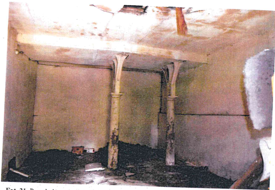
Fot. 31. Przechylone słupy żelwne nad dawnym kanałem, spękania i wybrzuszenia posadzki
