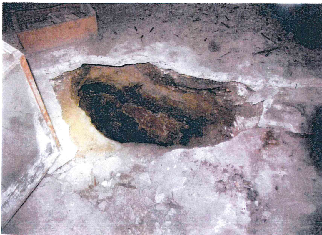
Fot. 16. Wnętrze części halowej; zapadlisko pod posadzką przy ścianach dawnego kanału; pod posadzką kamienne ściany kanału technologicznego i jednocześnie ściany fundamentowej ramy
