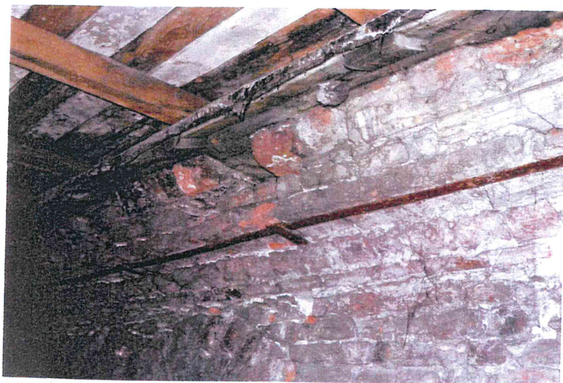
Rys. 15. Oryginalna forma gzymsu wieńczącego, zachowana w dobudówce, na fot. górnej zarysowany łuk nad dawnym kanałem
