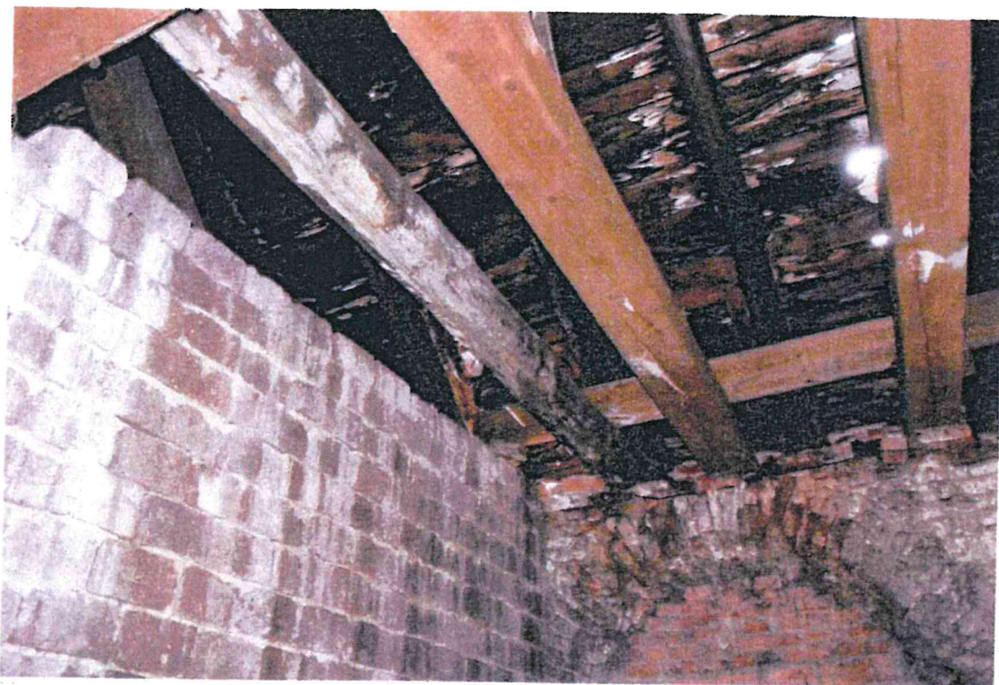
Fot. 21. Zniszczenia korozyjne więźby przy okapie nad ścianą południową – stan awaryjny
