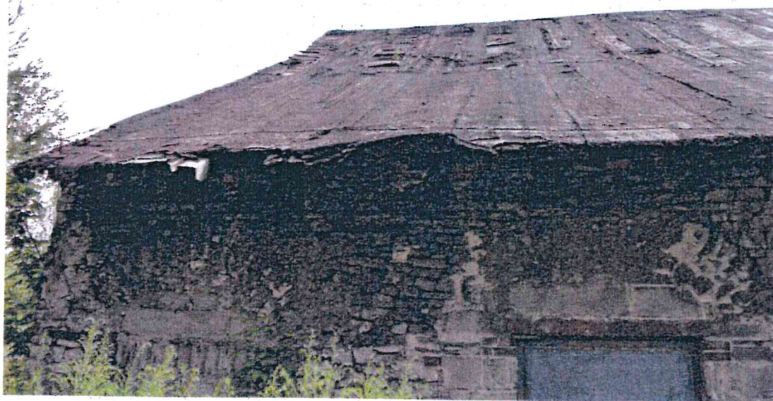
Fot. 7. Elewacja południowa, zdegradowany gzyms wieńczący; zniszczone pokrycie dachu i okap
