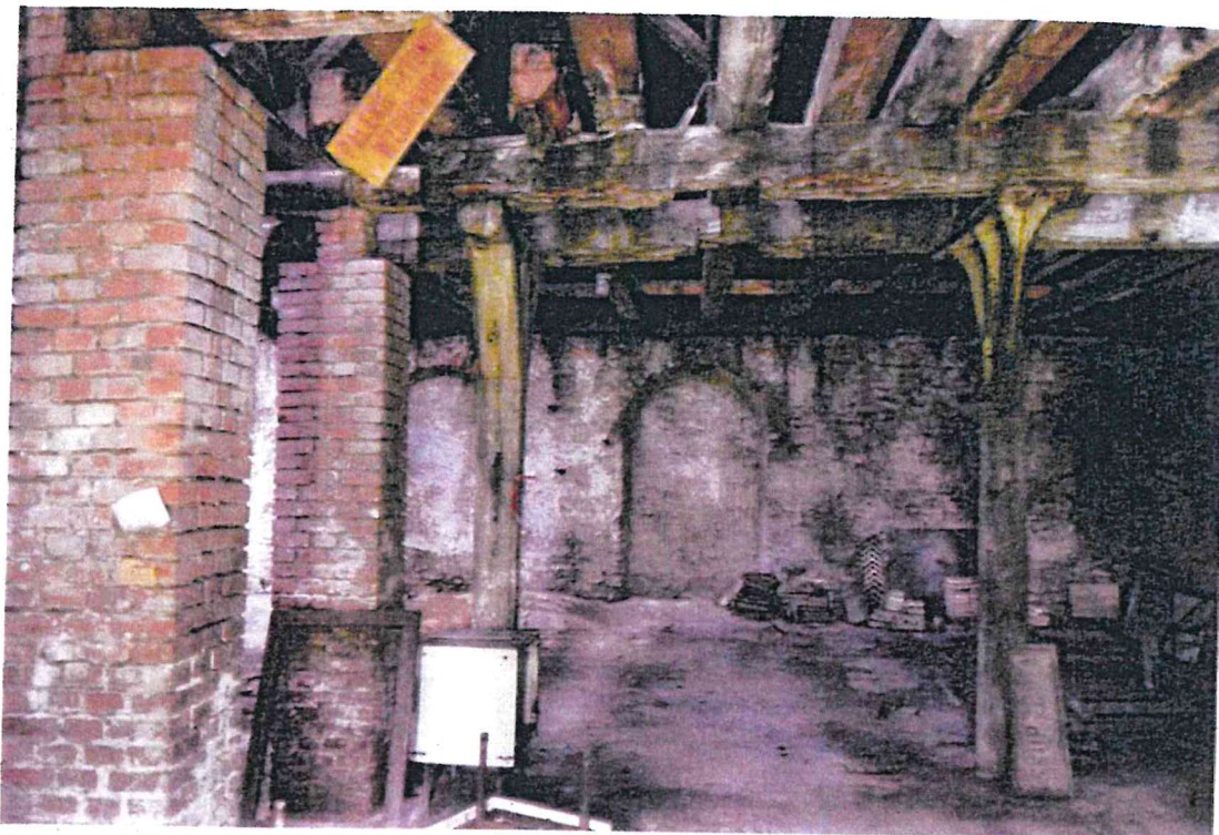
Fot. 13. Wnętrze części halowej (strona zachodnia); widok na ścianę północną; zniszczenia biologiczne drewnianych konstrukcji spowodowane zawilgoczeniami – przecieki przez dach
