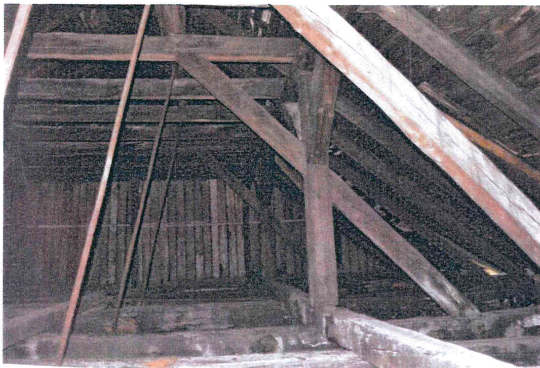
Rys. 17. Więźba dachowa; nad przebiegiem dawnego kanału belki wiązarowe dodatkowo podwieszane stalowymi wieszakami
