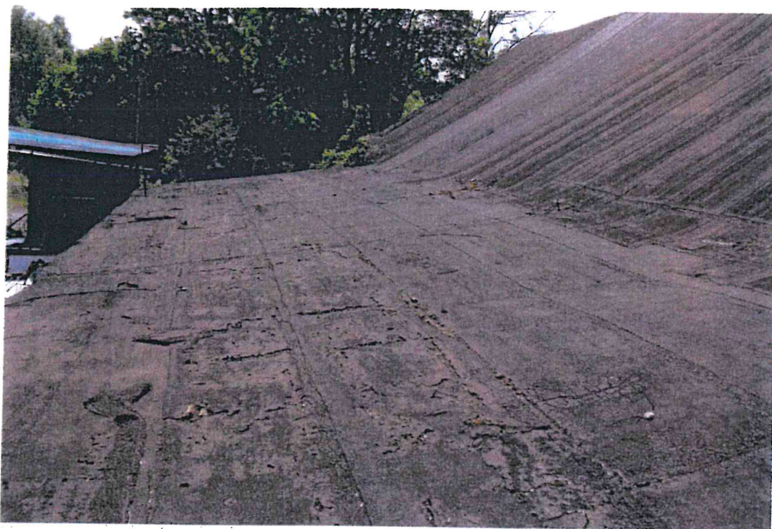
Fot. 39. Zniszczenia pokrycia dachu – połąć północna i dach przybudówki
