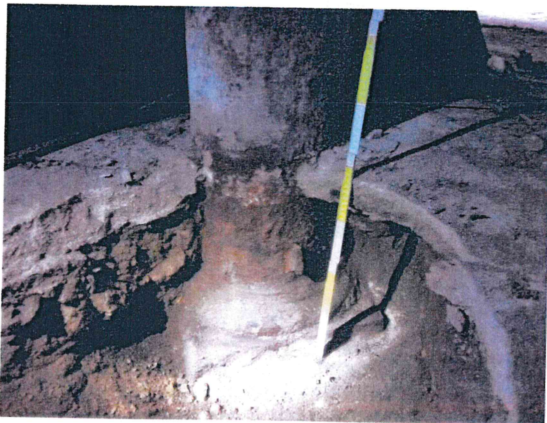
Fot. 29. Podstawa żeliwnych słupów położone 40 cm pod posadzkami
