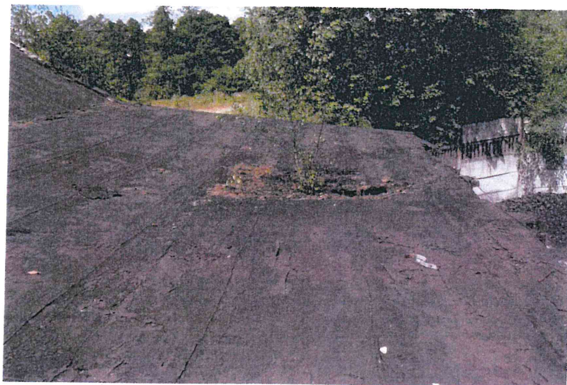
Fot. 40. Zniszczenia pokrycia dachu – połąć północna i dach przybudówki
