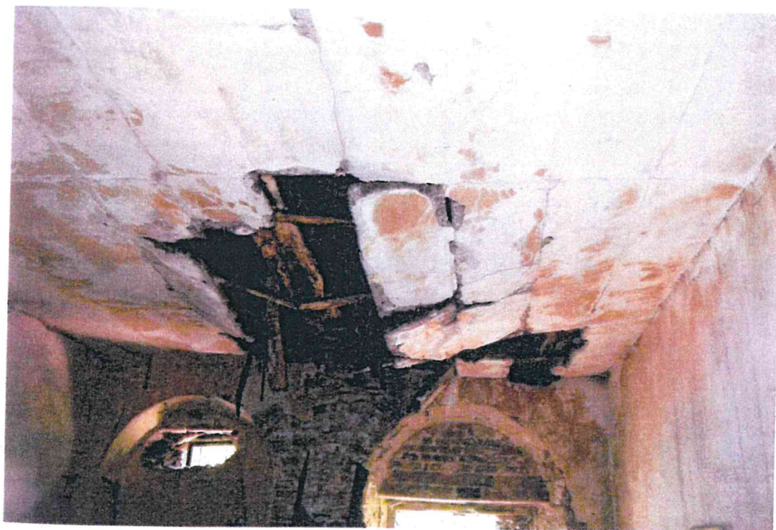
Fot. 22. Zniszczenia korozyjne więźby i sufitu przy okapie nad ścianą południową w magazynie zboża; zbutwiała belka więzarsowa – stan awaryjny
