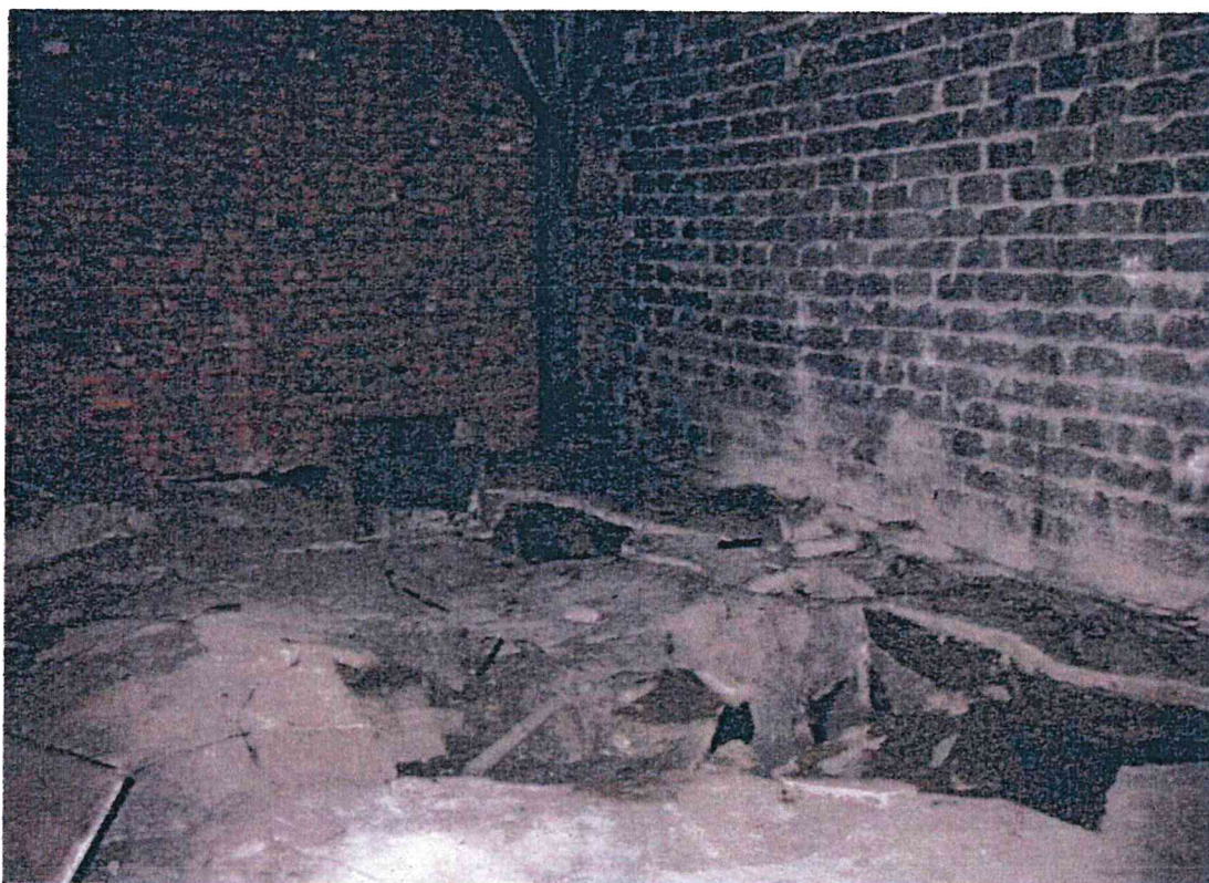
Fot. 15. Wnętrze części halowej (strona zachodnia); pustki i zapadliska pod zniszczoną betonową posadzką
