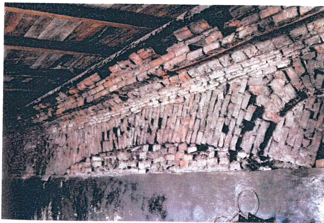
Fot. 8. Elewacja północna, zachowana forma gzymsu wieńczącego; zarys łuku nad dawnym kanałem ze śladem przebudowy; wyprawa cementowa boks magazynowego na ścianie
