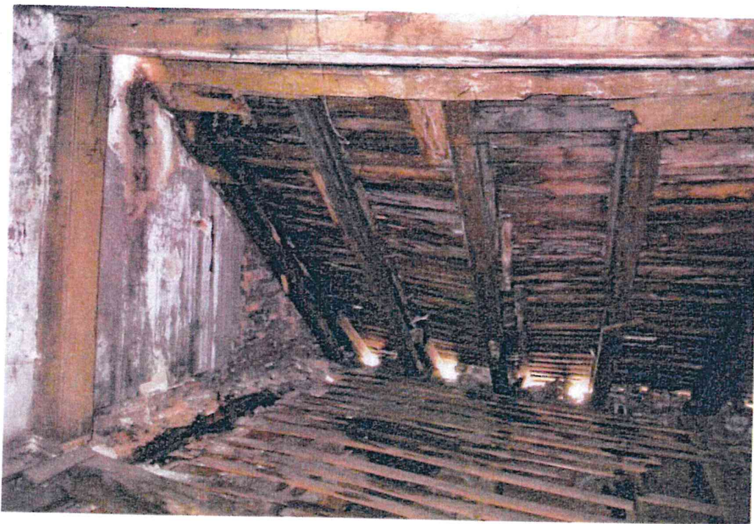
Fot. 23. Zniszczenia korozyjne więźby przy okapie nad ścianą południową, za szczytową ścianą wschodnią; ugięta płatek pod wymontowanym słupem ramy stolcowej
