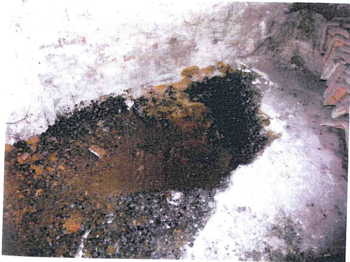
Fot. 18. Wnętrze części halowej; podłoże z żużla i siarka pod wybrzuszeniami betonowej posadzki przy ścianie północnej
