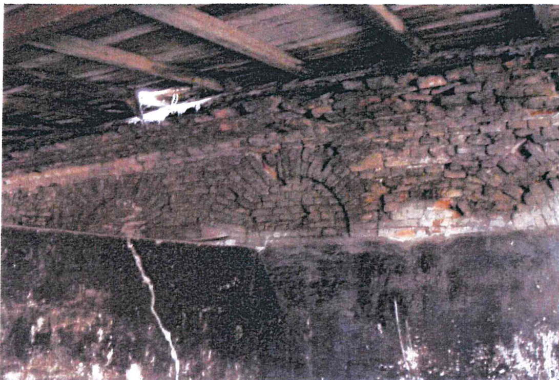
Fot. 9. Elewacja północna, zachowana forma gzymsu wieńczący, zarys łuków nad otworami; wyprawa cementowa boksów, przekrywająca ścianę na całej długości dobudówki
