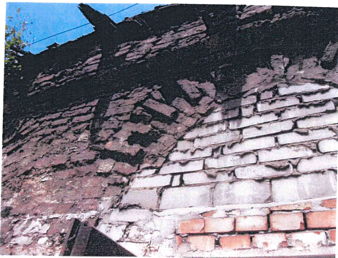
Fot. 5. Elewacja południowa, zdegradowany gzyms wieńczący
