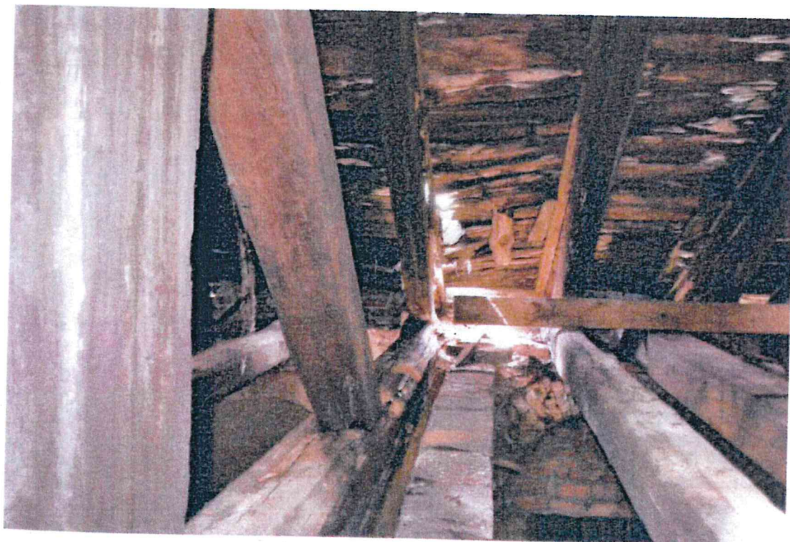
Fot. 20. Zniszczenia korozyjne więźby przy okapie nad ścianą południową – stan awaryjny
