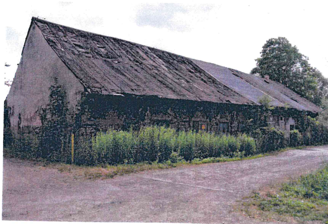
Fot. 38. Zniszczenia pokrycia dachu – połacie południowa
