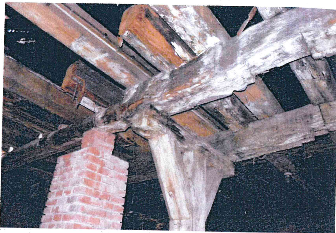
Fot. 19. Korozja i biologiczne zniszczenia drewnianych konstrukcji w części zachodniej, halowej
