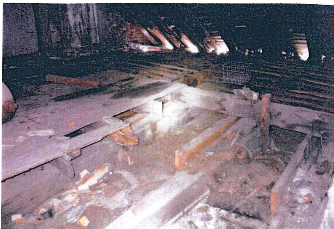
Fot. 25. Zniszczenia korozyjne i mechaniczne stropu nad byłą cukiernią; nieszczelności dachu
