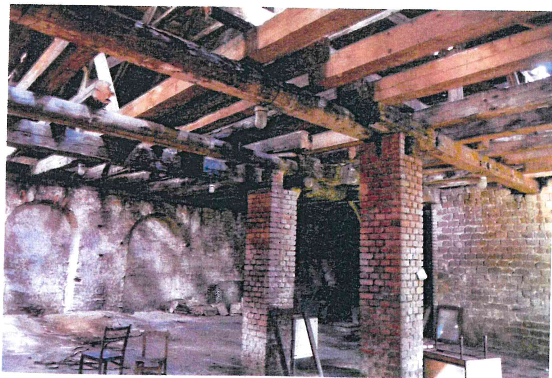
Fot. 14. Wnętrze części halowej (strona zachodnia); wtórne filary murowane; nowe belki więzaryowe
