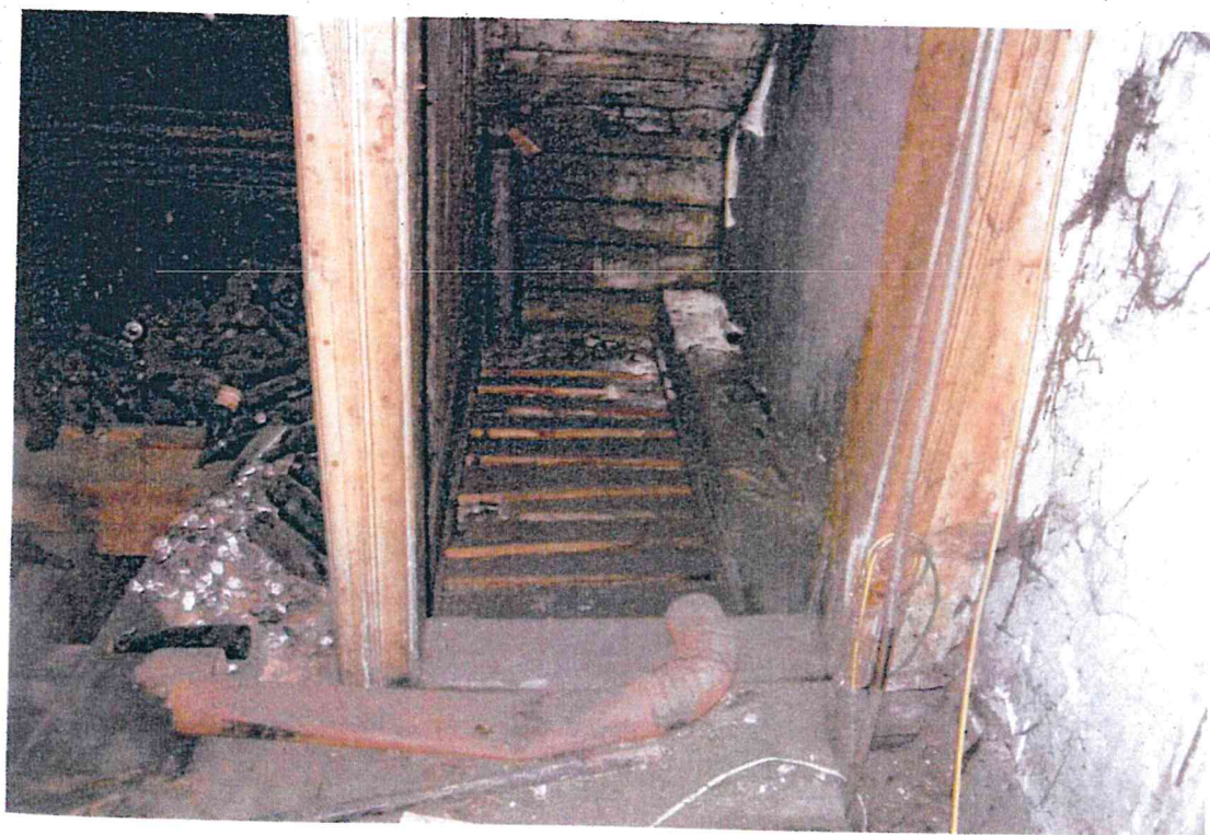
Fot. 24. Zasłepione wejście na poddasze przy szczytowej ścianie wschodniej
